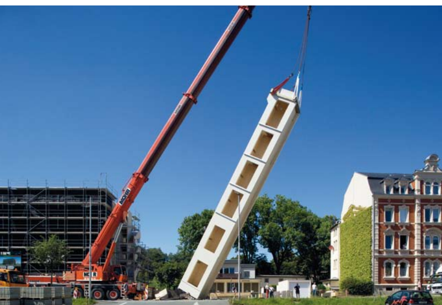
◀ Binnen sechs Tagen war der Baukörper komplett aufgestellt. Ein Kran hob den Aufzugschacht in den Rohbau ein
